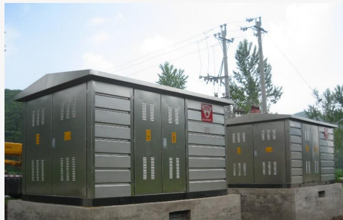
国网 400KVA 10kV箱变
