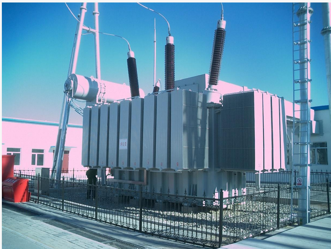
100MVA 220KV 辽宁开鲁建华风电厂
