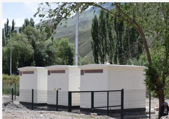
吉尔吉斯斯坦 6300KVA 35kV 预装式 变电站
